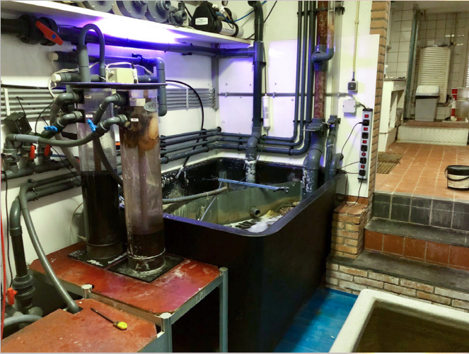
De technische ruimte
