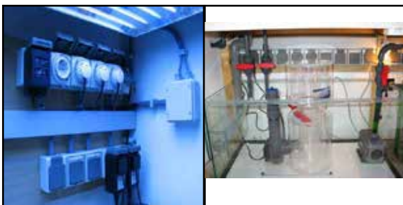
Spatwaterdichte stopcontacten onder en boven het aquarium
