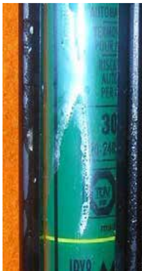
Condensvorming in de verwarming
