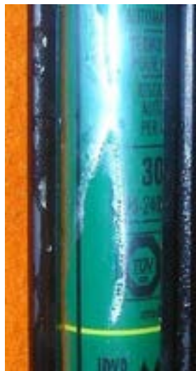
Condensvorming in de verwarming
